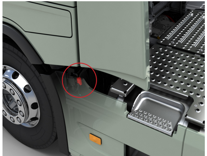
Interruptor principal para caixa de baterias na saliência traseira do chassis (MSWI-C).
